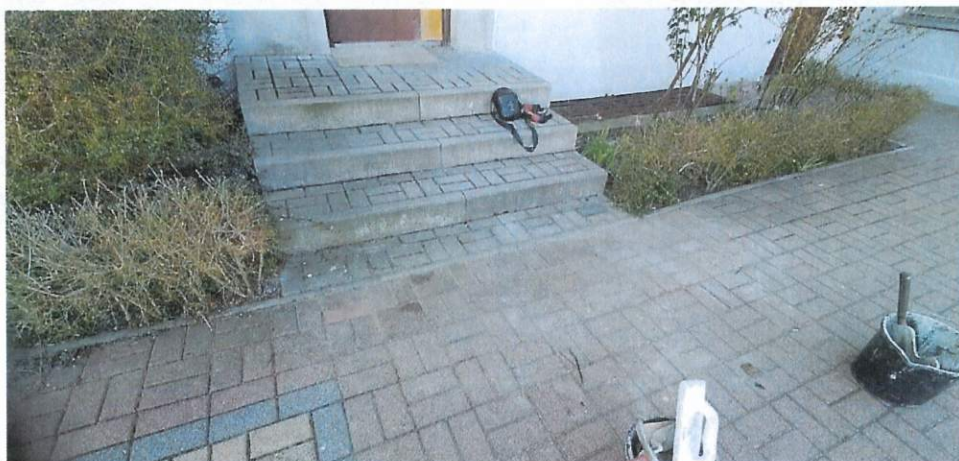
1.3. Miejscowa naprawa chodnika przed lokalem użytkowym ul. Wyszyńskiego 9 – spowodowana migracją gryzoni.
